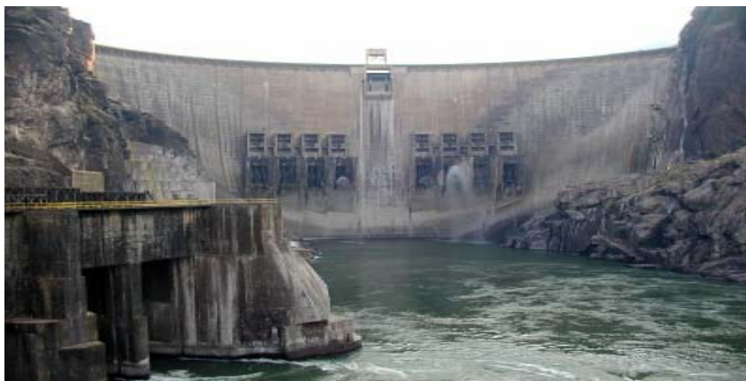
Foto 1: Barragem de Cahora Bassa, uma externalidade a produção de energia Fonte: HCB, 2006. Foto: MUNGUI, Cláudio.
